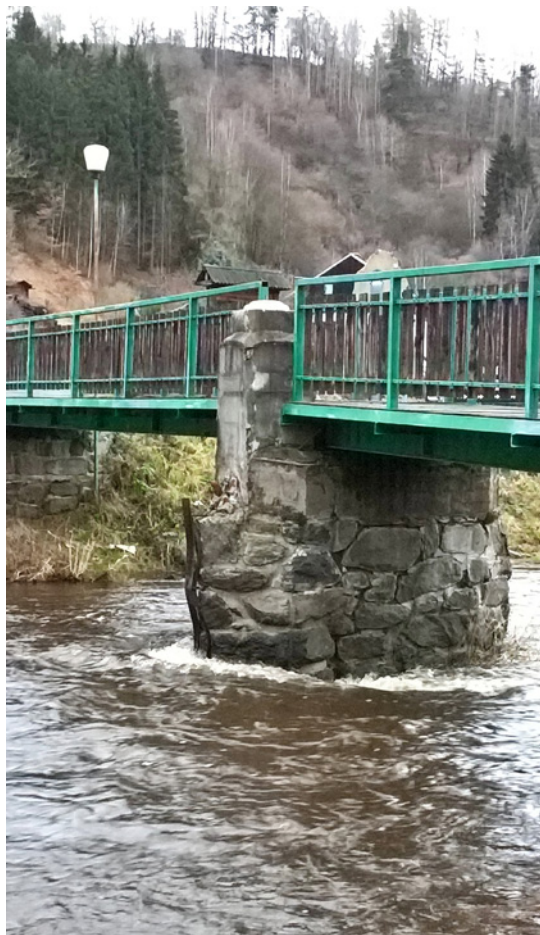
Lávka pod hradem přes řeku Teplá bude v červnových dnech zajištěna pro bezpečný průchod.
