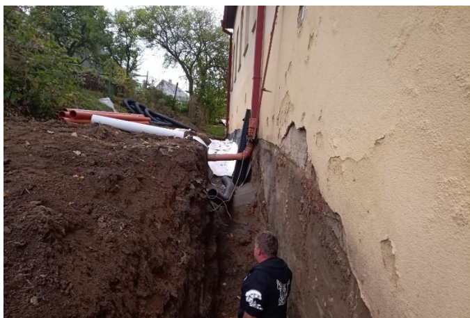
Odvodnění budovy základní školy
